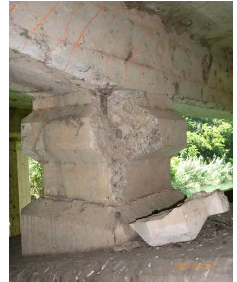
Spandrel Column - Spalling
